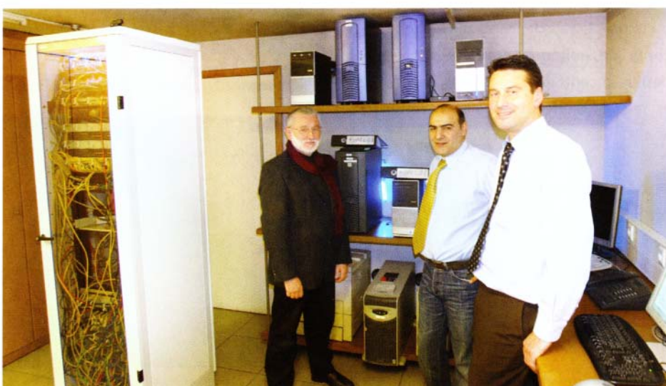
Dans la salle serveur, de chaque côté, Daniel et Daniel ont développé le progiciel sur une base WinDev.
